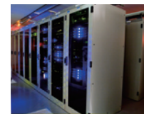
D@TA Center 【KYOCERA Communication Systems Co., Ltd.】
